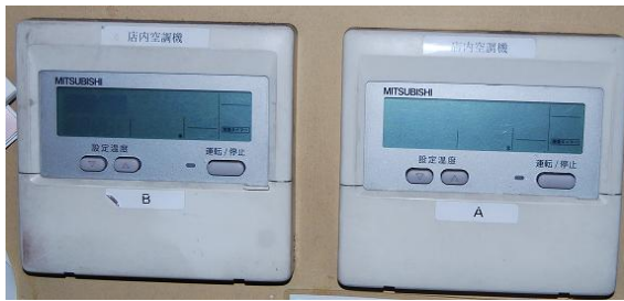
↑ 2台あるエアコンは OFF 中
